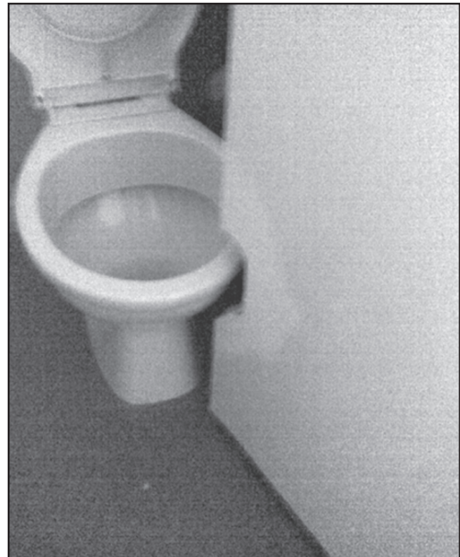
На снимките ясно се вижда "качеството" на ремонта в санитарния възел
