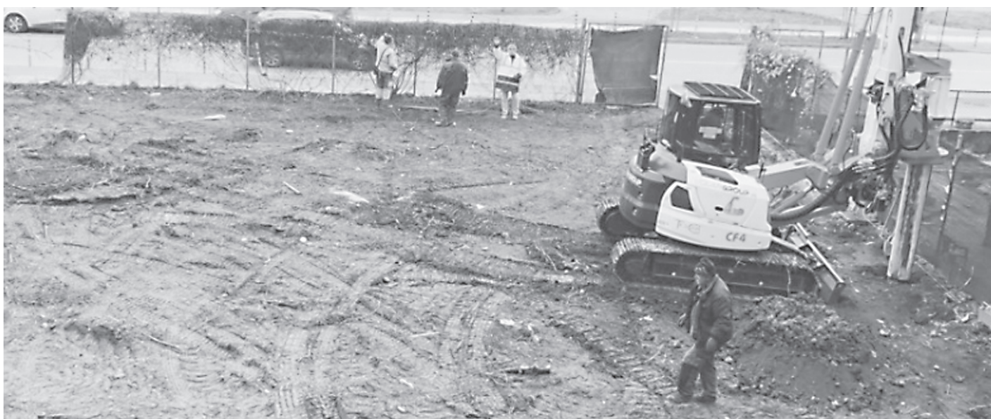
Жители на столичния квартал "Бъкстон" излязоха на протест заради започнат строеж на нова офис сграда на броеви метри от прозорците на домовете им. ДНКС задължи районната администрация до 10 дни да направи проверка по казуса
